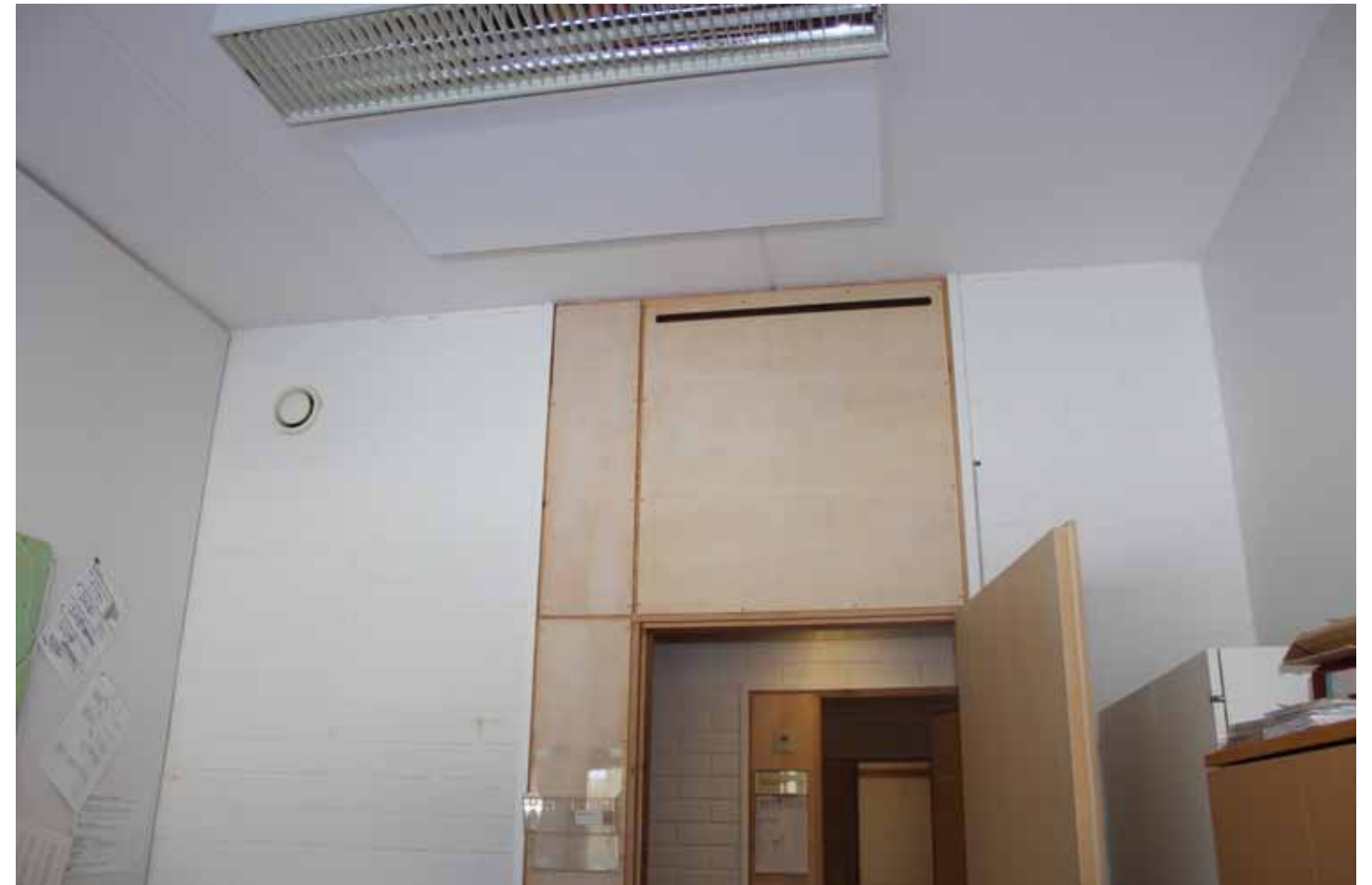
Työhuone 319 kolmannessa kerroksessa. Tyypillinen työhuoneiden ilmanvaihtojärjestely.
